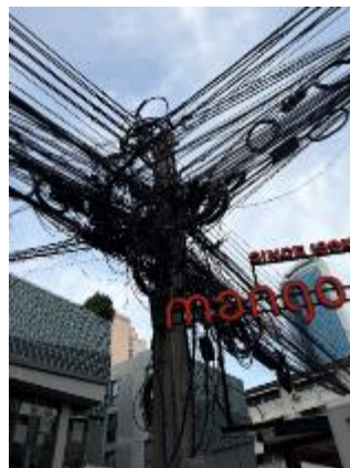
複雑に絡まっている電線の様子
