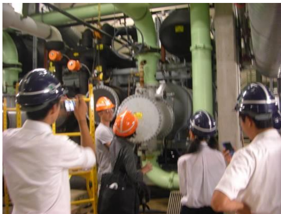
下水熱再生システムプラントの見学
